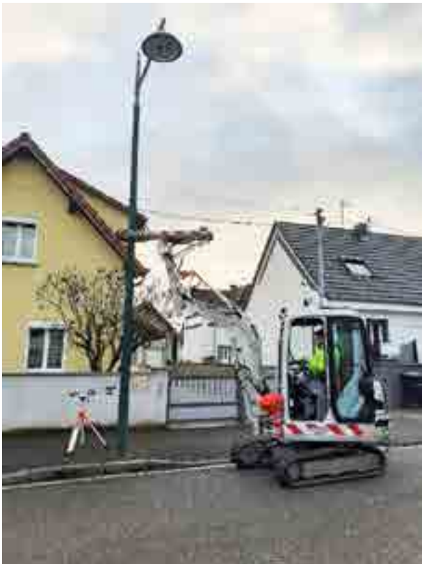
Test de résistance des candélabres demandé par la C.A.H et réalisé par la société Roch Service, de Cergy-Pontoise
